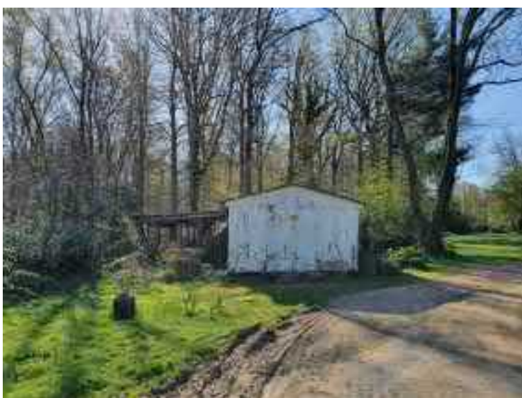
Abb. 8 In Teilen baufälliger Schuppen
